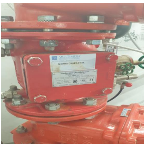
Sl. 16. Sprinkler ventil mokri [10]
