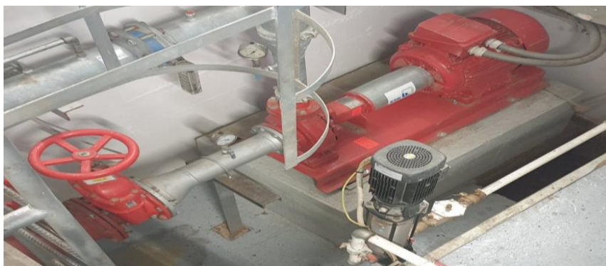
Sl. 17. Sprinkler pumpa [10]
