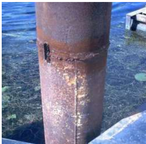
Slika 7. Korozija cjevovoda u vodenom okolišu (Alhaboubi, 2014.)
