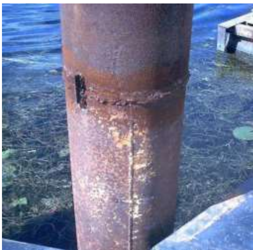
Slika 7. Korozija cjevovoda u vodenom okolišu (Alhaboubi, 2014.)
