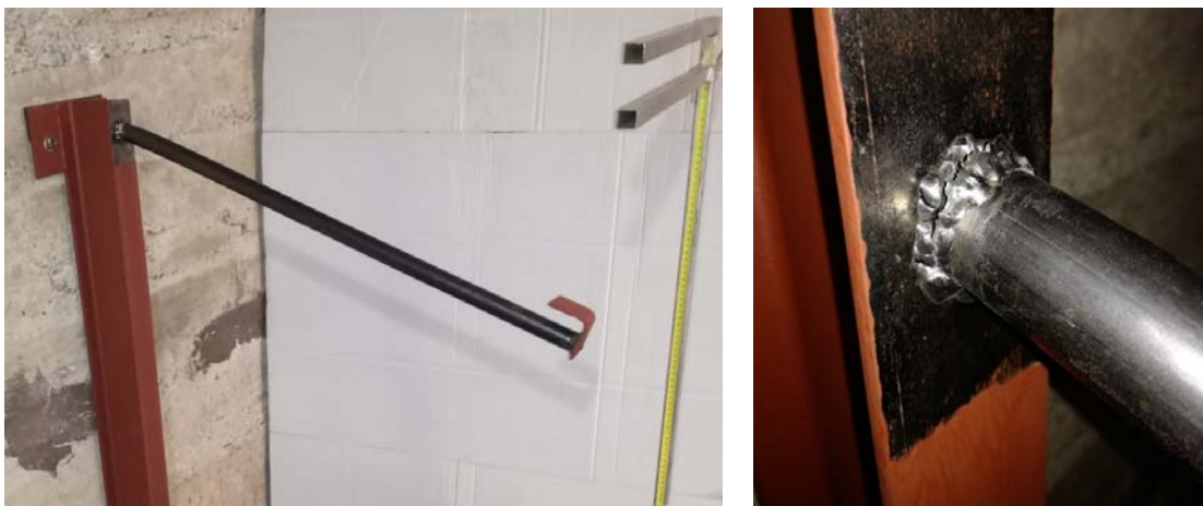
Slika 26. Puknuće zavarenog spoja uslijed naprezanja, cijev promjera 26.9mm
