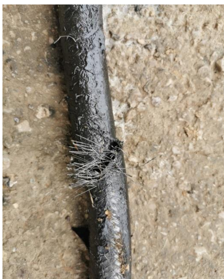
Slika 62. Pucanje fleksibilnog hidrauličnog voda
