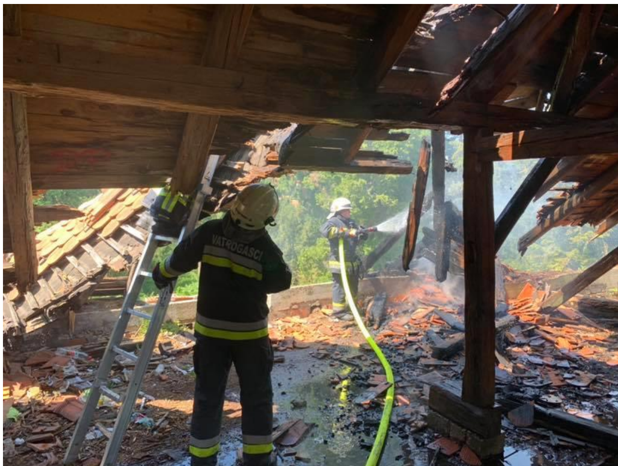
Slika 9. Dokumentacija tijekom intervencije gašenja požara na dvorcu Wagner 32
