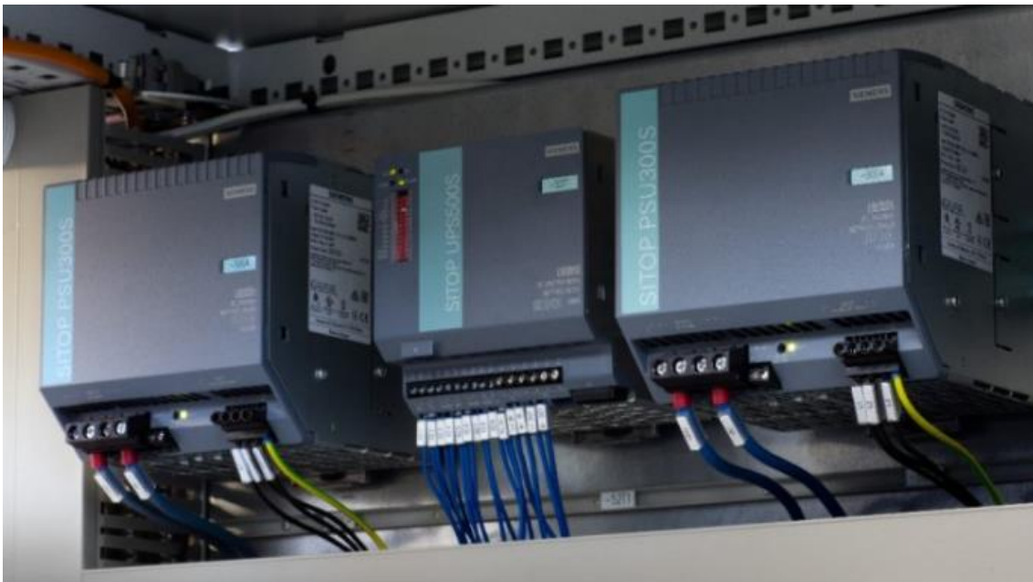
Slika 10. Prikaz spojenih UPS uređaja u nekom razvodnom ormaru [12]
