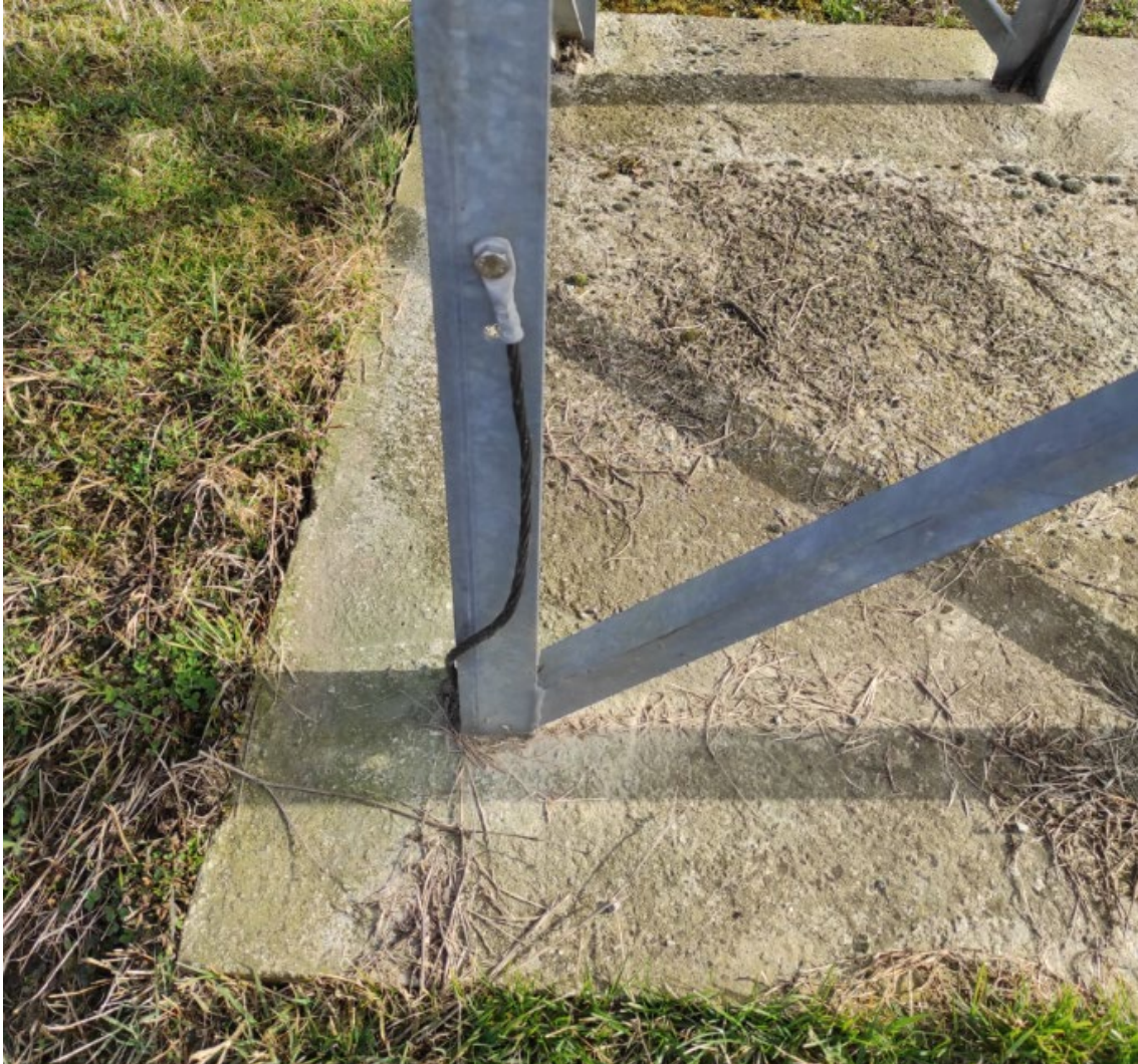
Slika 6. Uzemljenje na čelično-rešetkastom stupu trafostanice
