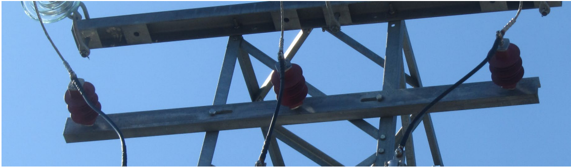
Slika 17 Ugrađeni Raychem odvodnici prenapona na čelično-rešetkastom stupu trafostanice
