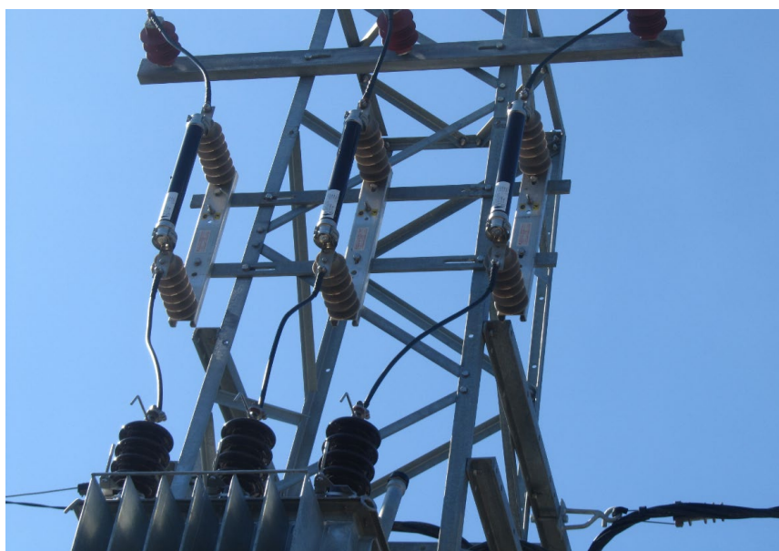
Slika 4 Prikaz dolaza viskog napona na trafostanicu
