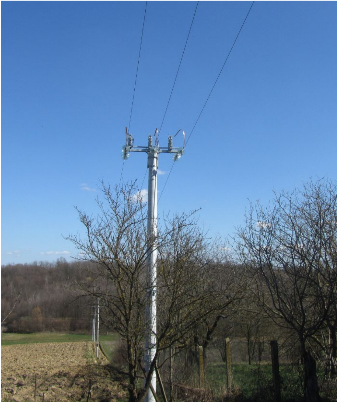
Slika 2 Betonski stup dalekovoda 10kV s linijskim rastavljačem
