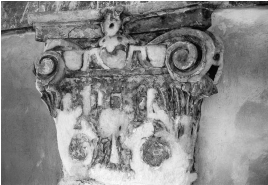
Slika 14. - Vidljiva požarna oštećenja arhitektonskog kamena na crkvi Sv. Mihovila u Budimpešti[30]
