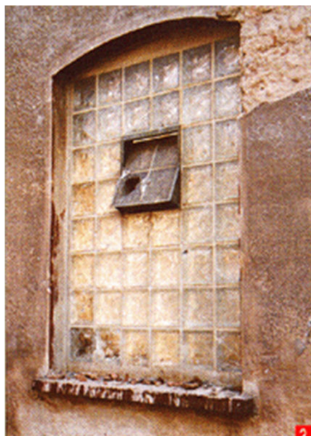
Slika 26. - Prozor ostakljen staklenim opekama nakon požara[32]
