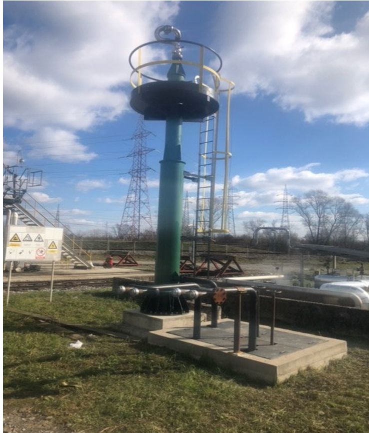
Slika 11. Stabilni bacač voda/pjena na MM2 [7]
