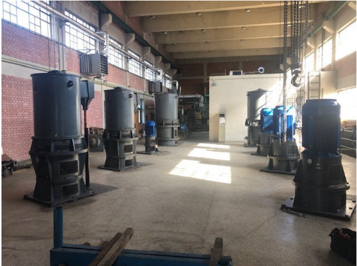
Slika 19. Unutrašnjost pumpaonice s pumpama [7]
