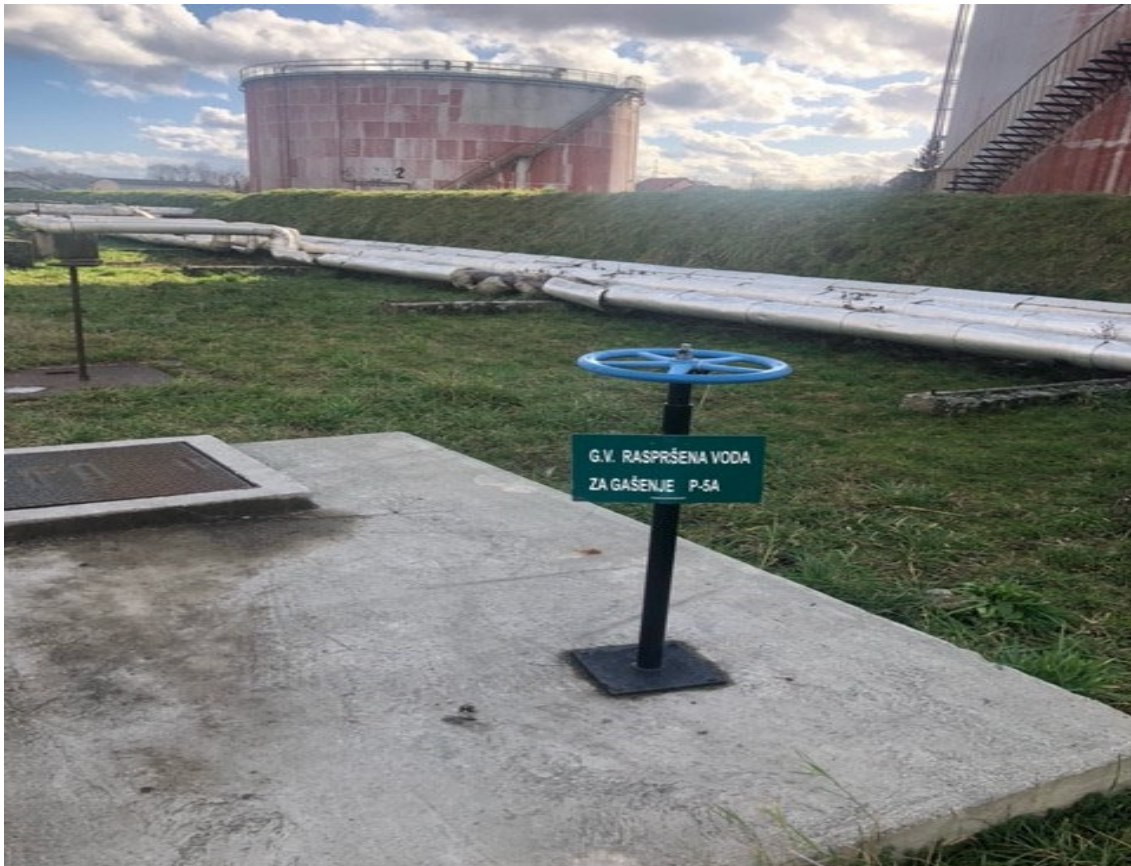
Slika 9. Glavni ventil za ručno otvaranje drencher sustava [7]
