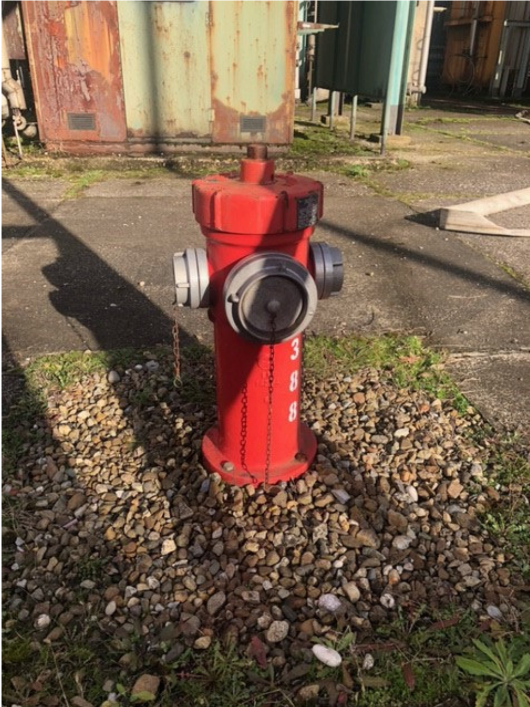
Slika 3. Visoko tlačni nadzemni hidrant [7]
