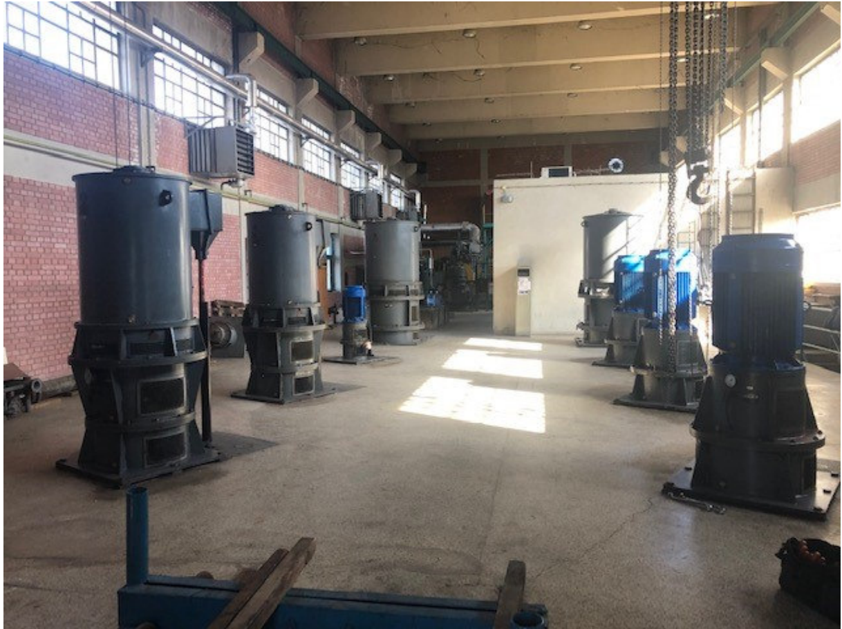
Slika 19. Unutrašnjost pumpaonice s pumpama [7]
