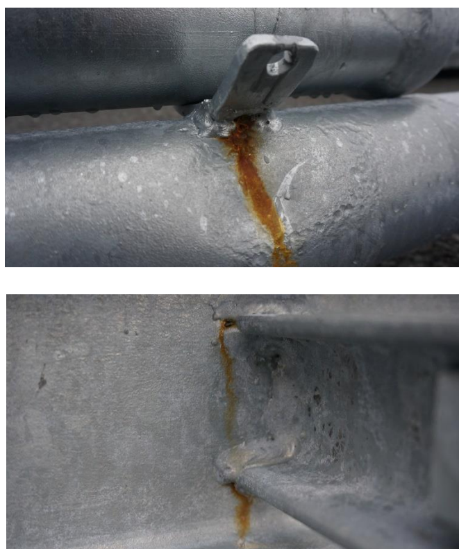
Slika 46. Loše izvedeni zavari[7]
