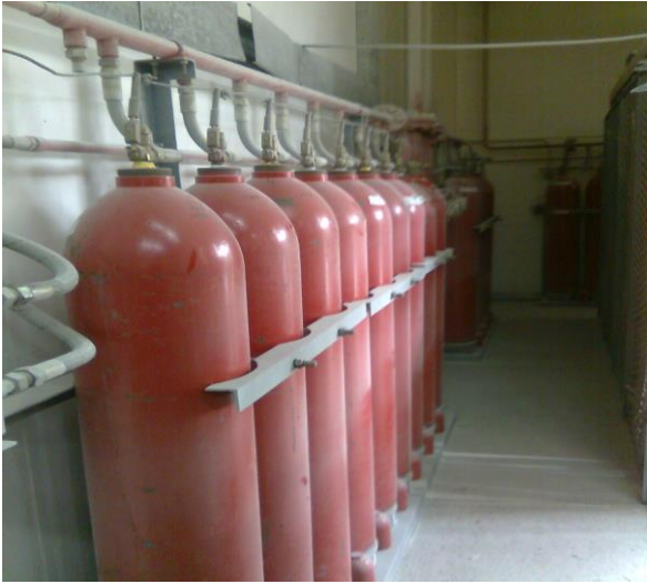
Slika 20. Baterije boca sa CO 2
