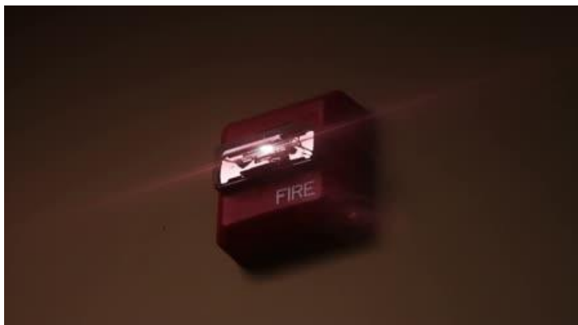
Slika 35. Svjetlosna signalizacija požara
