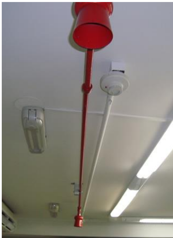
Slika 33. Detektori požara uz sustav za gašenje ugljičnim dioksidom
