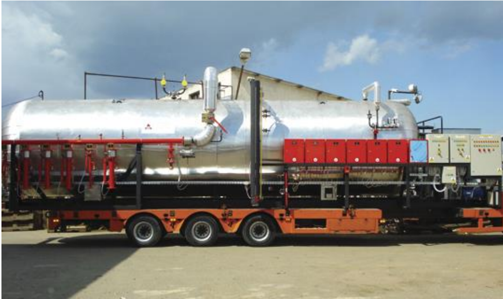
Slika 22. Spremnik CO 2 u niskotlačnom sustavu za gašenje požara
