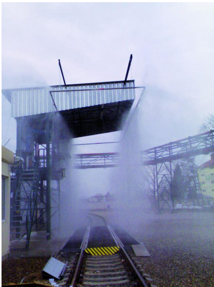
Slika 5. Drencher sustav na pretakalištu za vagon cisterne
