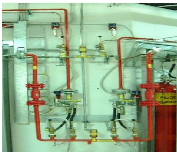
Slika 28. Cjevovod sustava za gašenje požara ugljičnim dioksidom [15]
