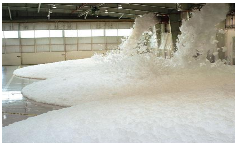
Slika 7. Sustav za gašenje pjenom u hangarima
