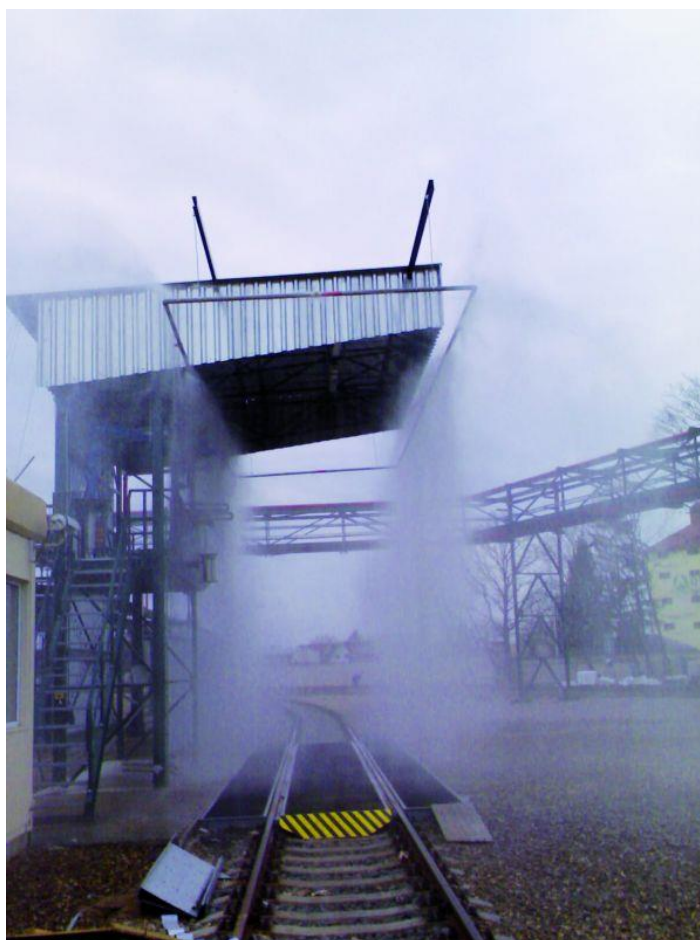
Slika 5. Drencher sustav na pretakalištu za vagon cisterne
