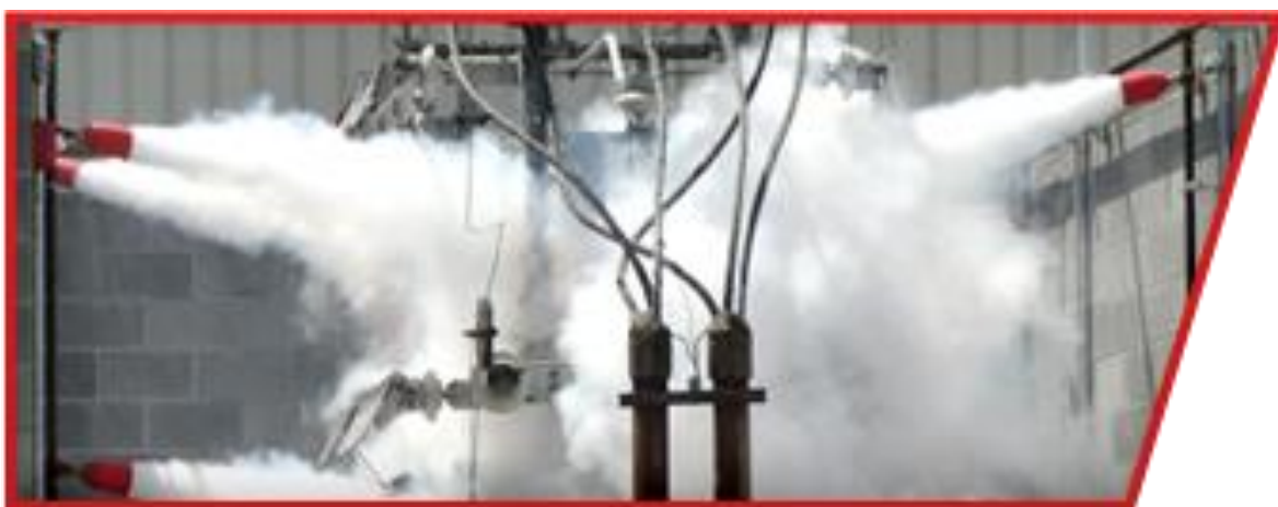
Slika 24. Djelomična zaštita transformatora sustavom za gašenje ugljičnim dioksidom
