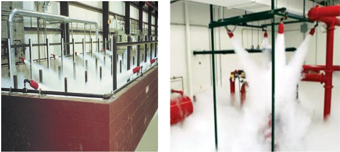
Slika 30. Ispuštanje ugljičnog dioksida na mlaznicama
