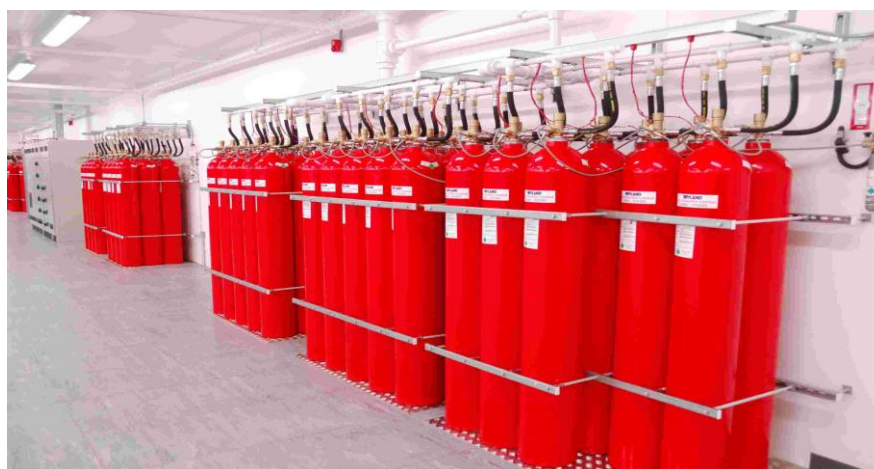
Slika 26. Spremnici (baterije) ugljičnog dioksida u visokotlačnom sustavu za gašenje požara [16]
