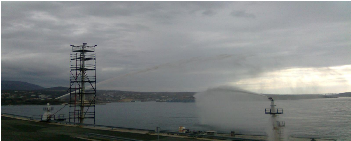
Slika 14. Daljinski upravljani bacači vode na pretakalištu plina u rafineriji Urinj u Rijeci
