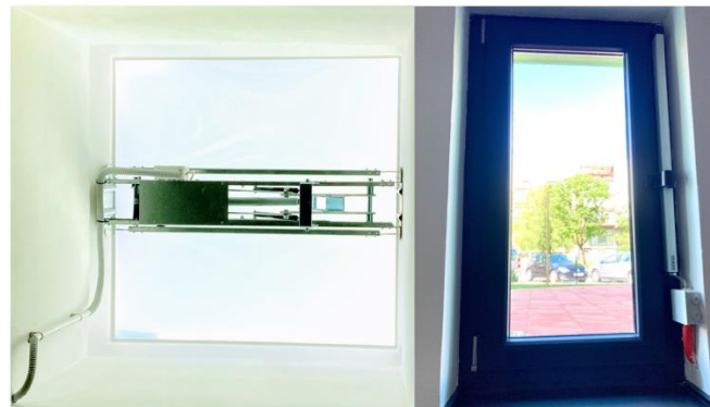
Slika 9. Automatski sustav odimljavanja (otvori za odimljavanje) [1]
