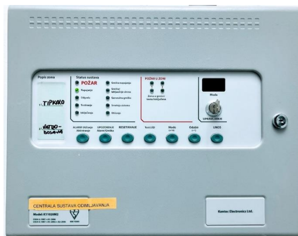
Slika 10. Primjer vatrodojavne centrale [1]
