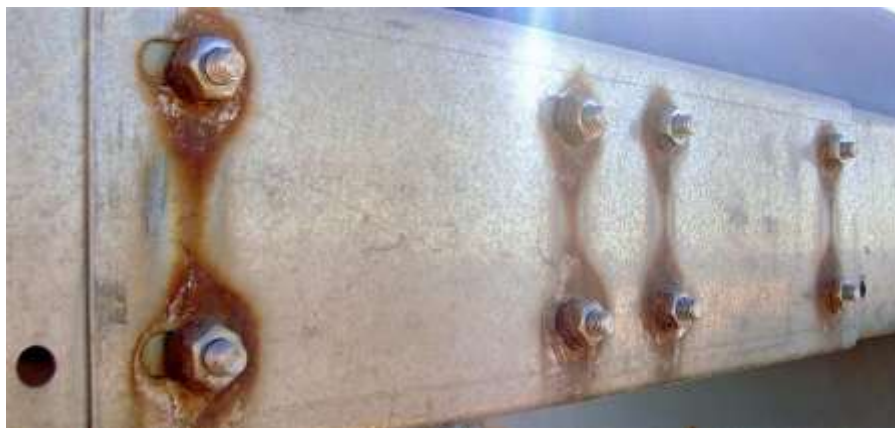
Slika 8. Primjer galvanske korozije
