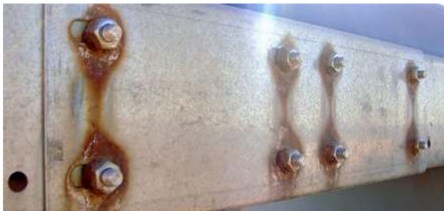
Slika 8. Primjer galvanske korozije
