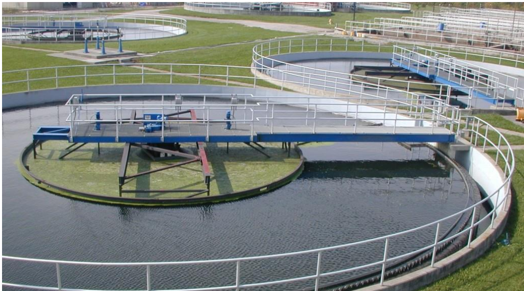
Slika 3. Postrojenje za obradu otpadnih voda [15]
