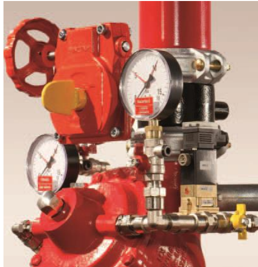
Sl. 6. Prikaz drencher stanice [5]
