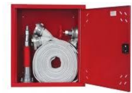
Sl. 11. Prikaz ormarića unutarnje hidrantske mreže [5]
