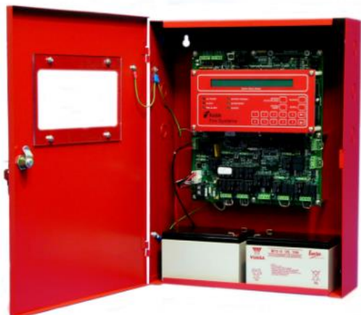
Slika 16. Vatrodojavna centrala u stabilnom sustavu [7]
