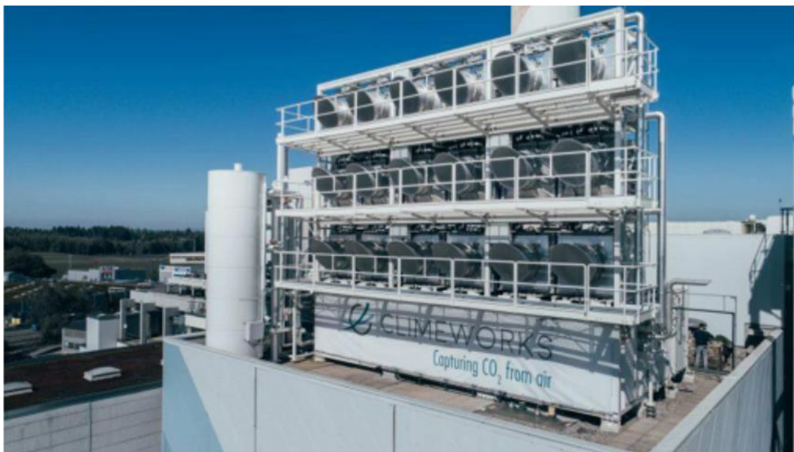
Slika 5. Prvo svjetsko komercijalno postrojenje za izravno sakupljanje CO 2 iz atmosfere koje je smješteno u Hinwilu u Švicarskoj [34]
