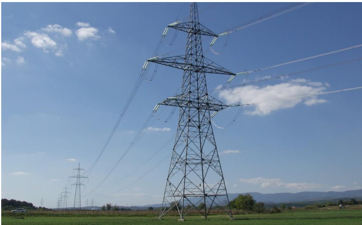
Slika 4. Dalekovod izrađen kao rešetkasta konstrukcija [21]
