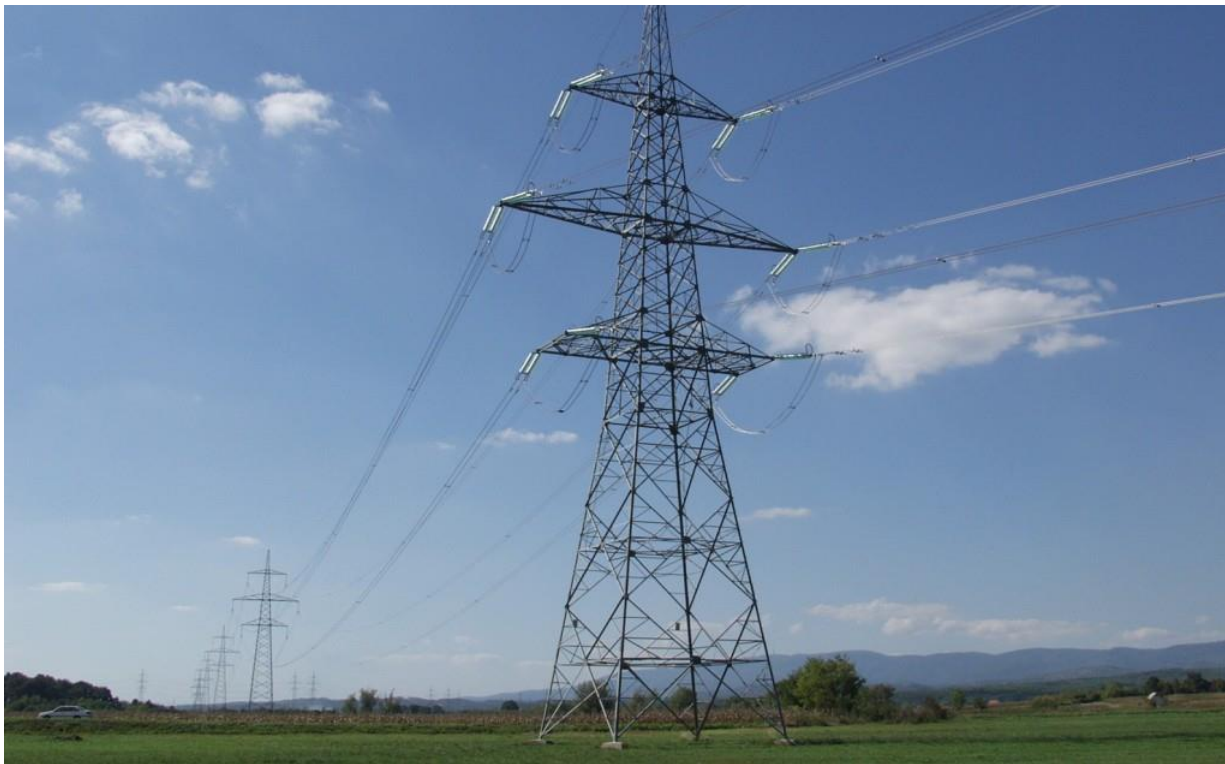
Slika 4. Dalekovod izrađen kao rešetkasta konstrukcija [21]
