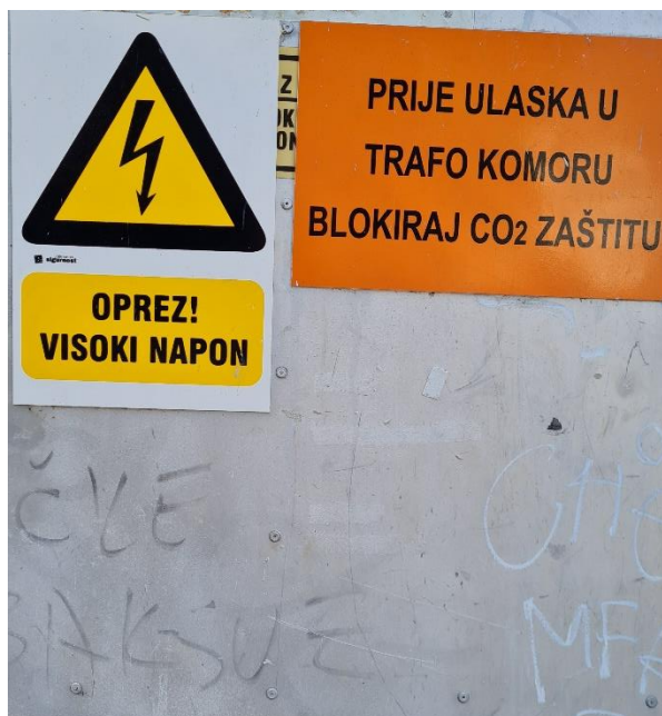
Slika 5. Prikaz ulaza u trafo komoru [9]
