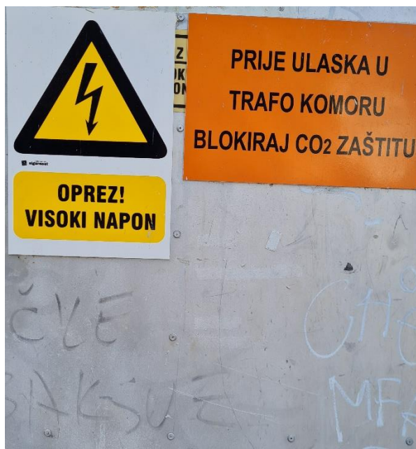
Slika 5. Prikaz ulaza u trafo komoru [9]
