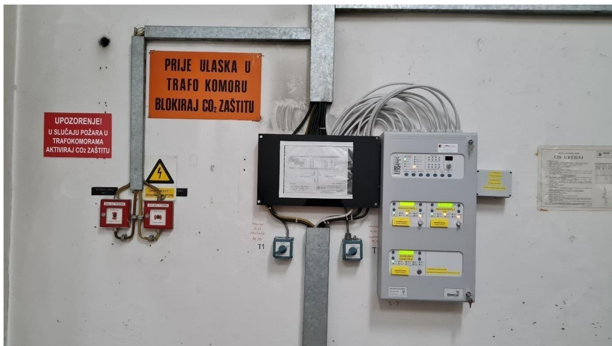
Slika 7. Elektro dio sustava gašenja požara plinom CO 2 [9]
