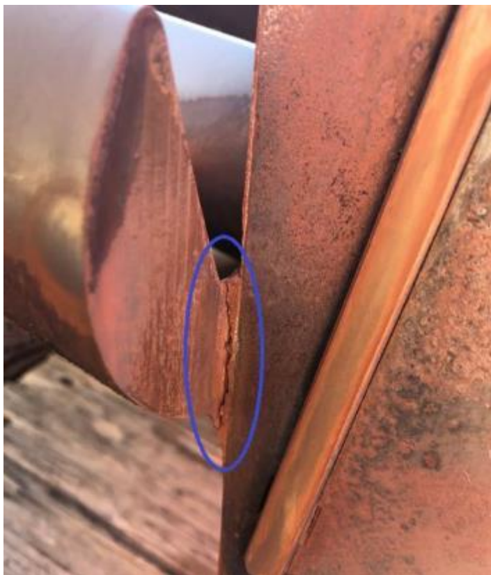
Slika 22. Pukotina na zavaru lopatice i unutarnjeg prstena dijafragme
