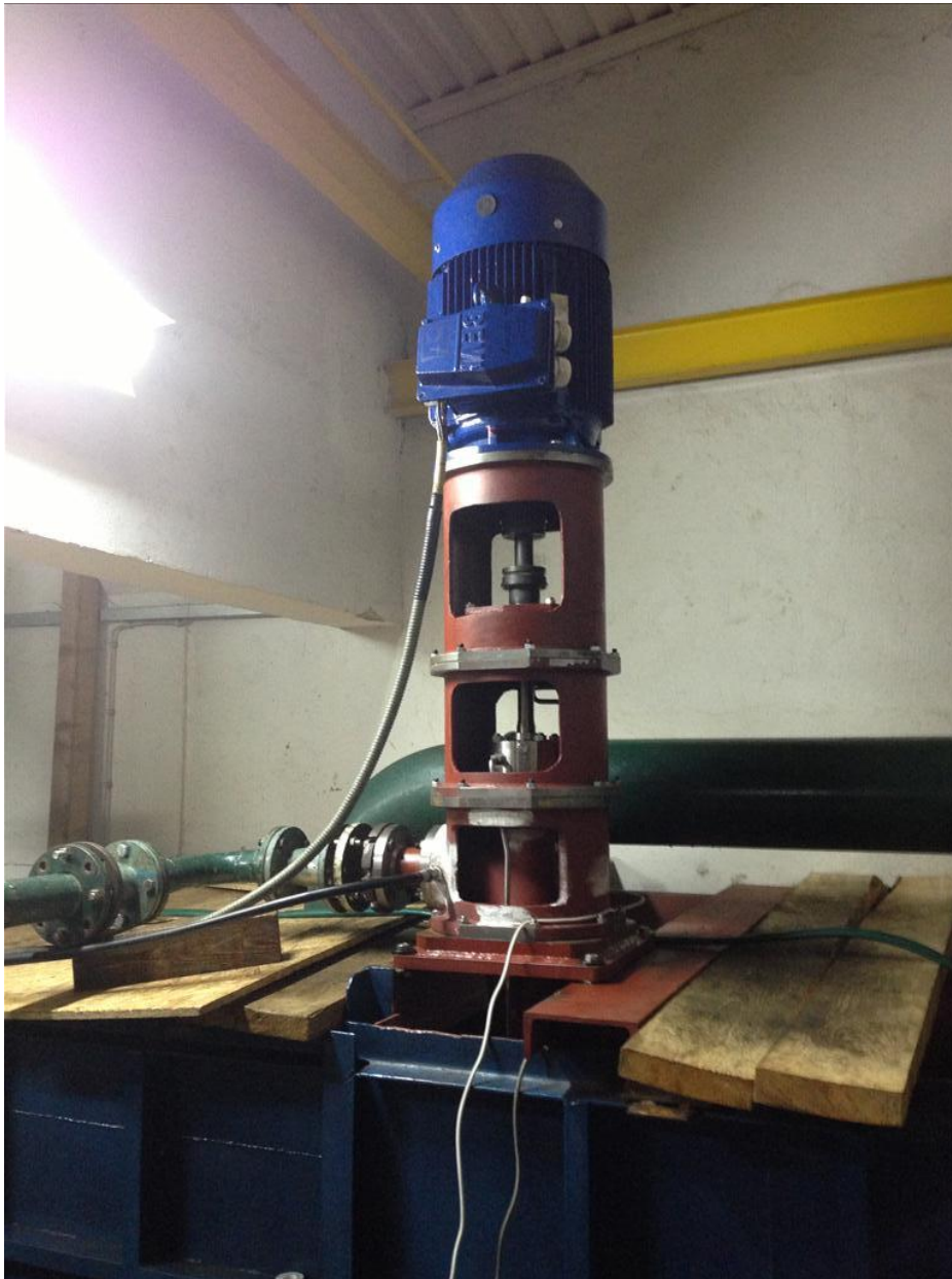
Slika 4. Ispitivana pumpa na spremniku ispitne stanice [9]
