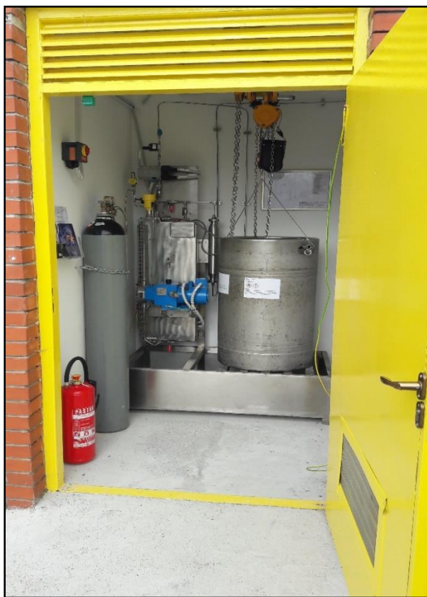
Slika 11. Plinska odorizacijska stanica
