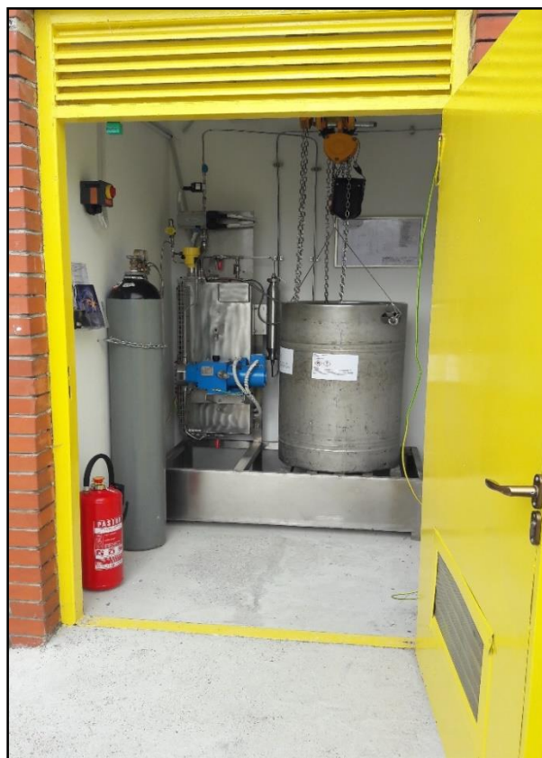
Slika 11. Plinska odorizacijska stanica
