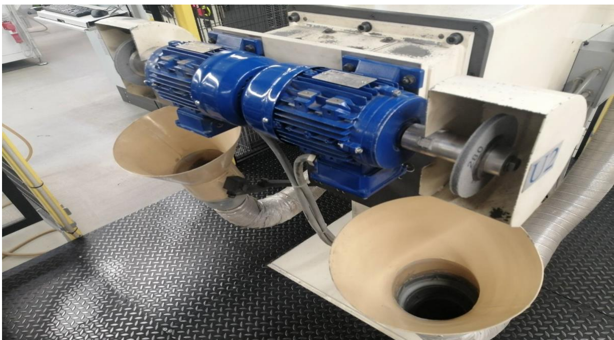
Slika 24. Dva brusna kotača s ventilacijom
