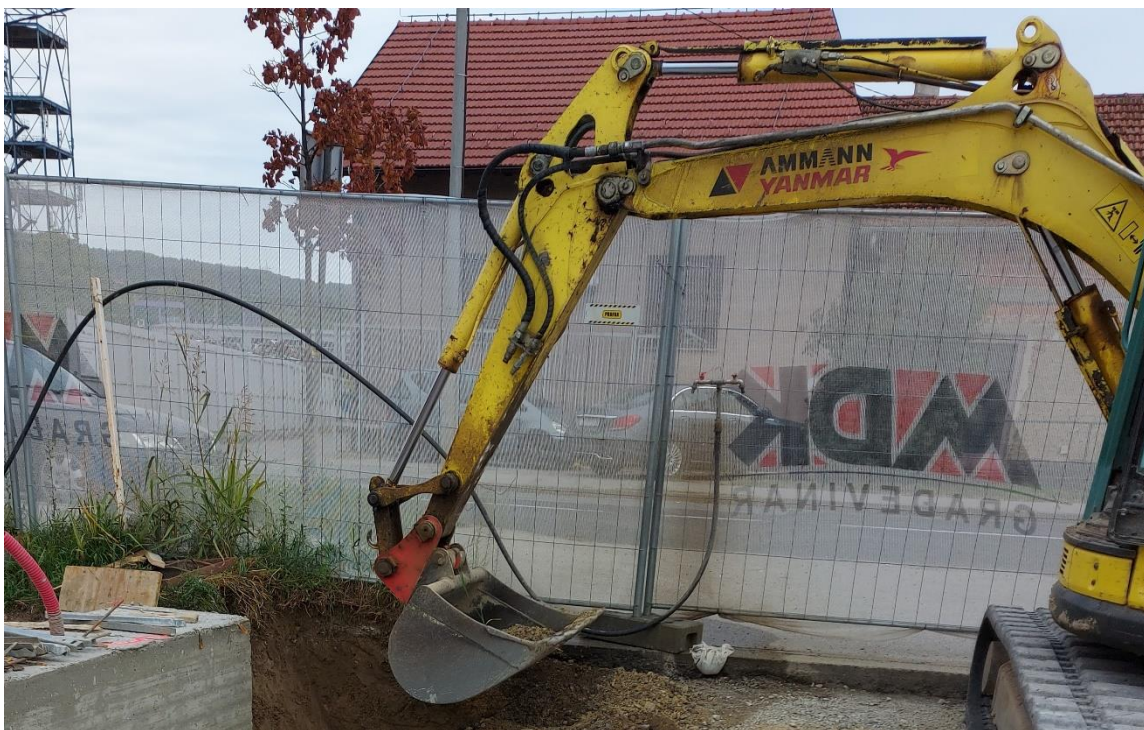
Slika 10. Privremeni priključak za vodu izveden za potrebe gradilišta
