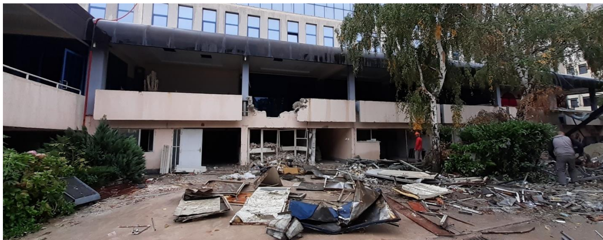
Slika 8. Neoznačeni radni prostor gdje se spušta otpadni materijal
