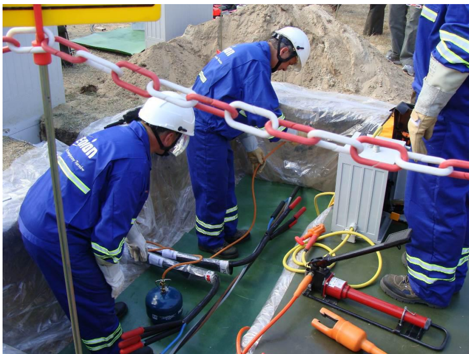
Slika 27. Kako se mora pripremiti radno mjesto za RPN na podzemnim kabelima [Vlastiti izvor]
