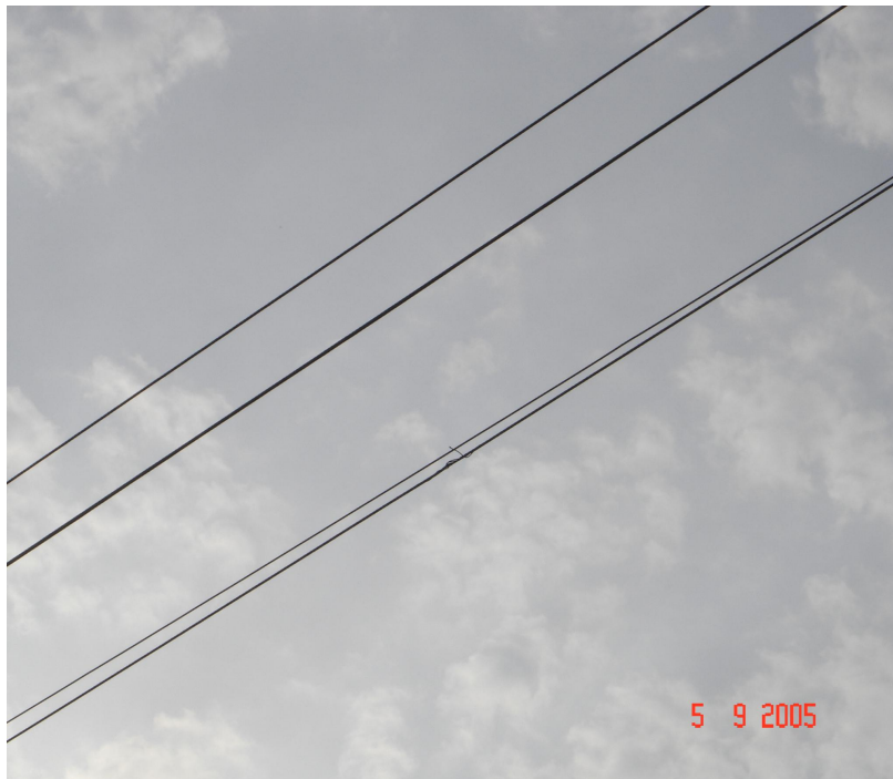
Slika 16. Primjer oštećenog vodiča [Vlastiti izvor]
