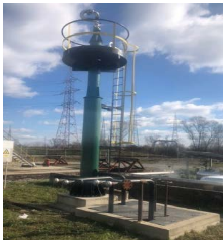
Slika 14. Stabilni bacači voda/pjena na MM2.[5]
