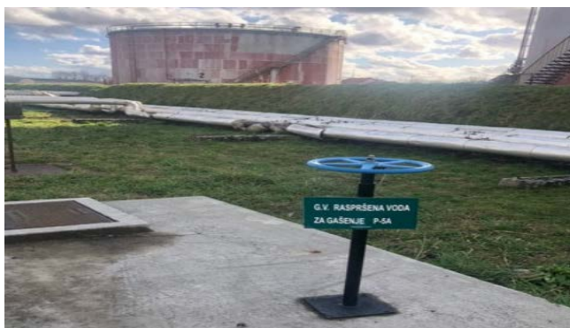
Slika 12. Glavni ventil za ručno otvaranje tzv. Drencher sustava.[5]
