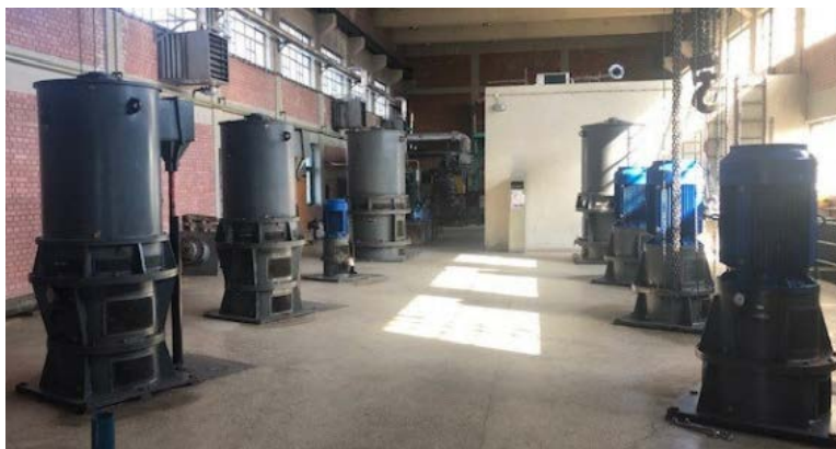
Slika 7. Unutrašnjost pumpaonice sa pumpama.[5]
