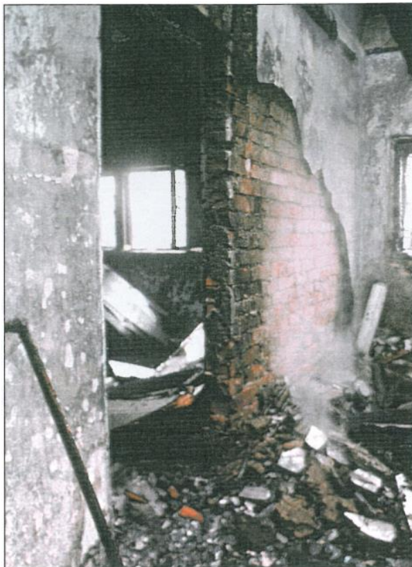
Slika 27. Otpala žbuka na intenzivnom djelovanju požara [10]
