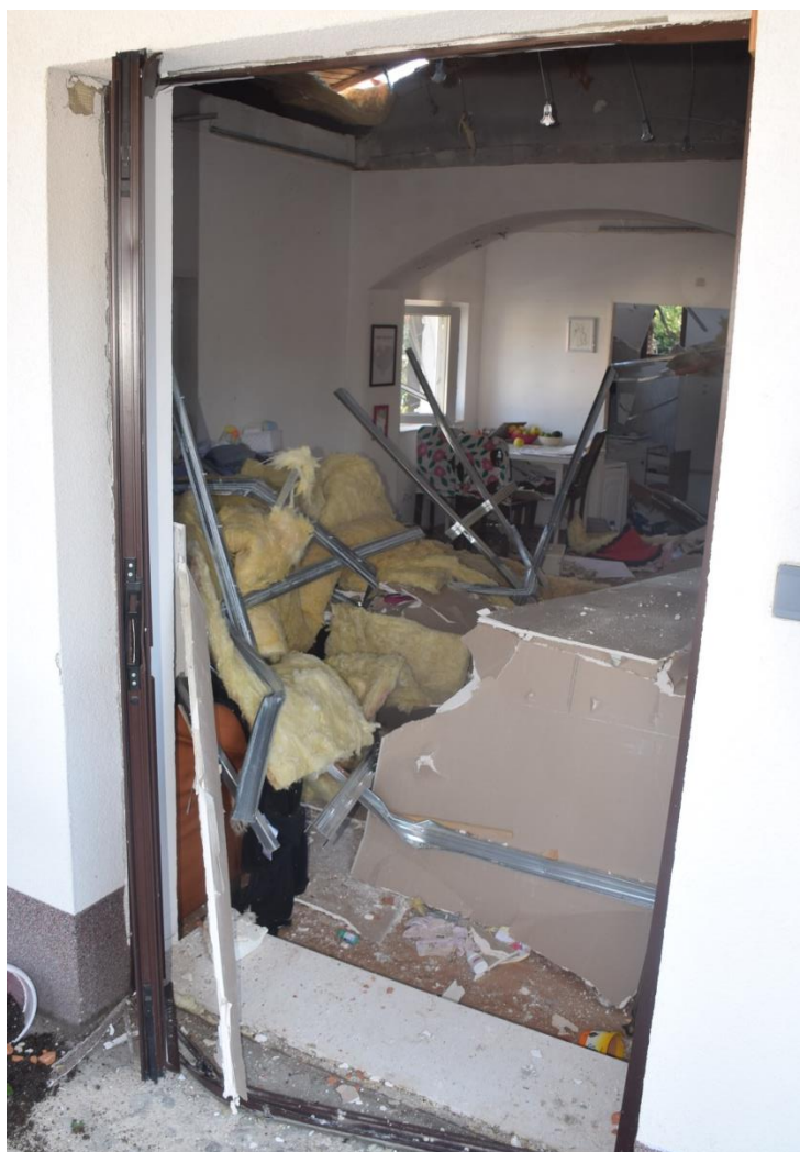
Slika 39. Vrata izvan ležišta te puknuto krovništvo [18]
