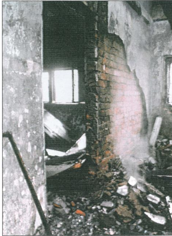
Slika 27. Otpala žbuka na intenzivnom djelovanju požara [10]
