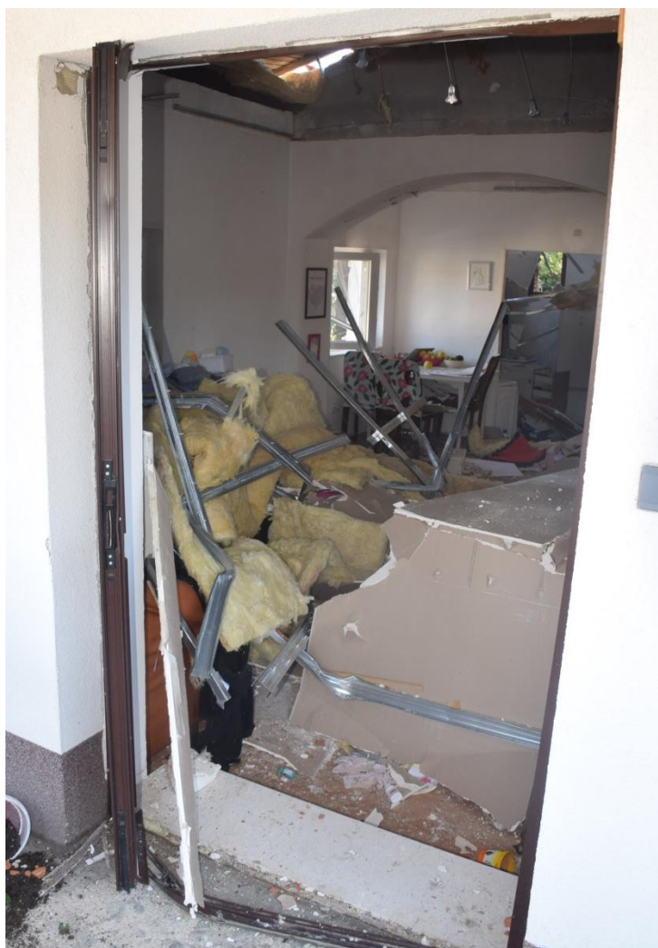
Slika 39. Vrata izvan ležišta te puknuto krovništvo [18]
