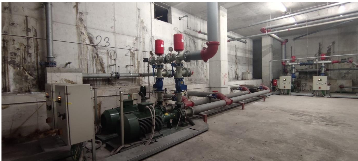
Slika 8. Pumpe u sprinkler stanici (Izvor: Autor)
