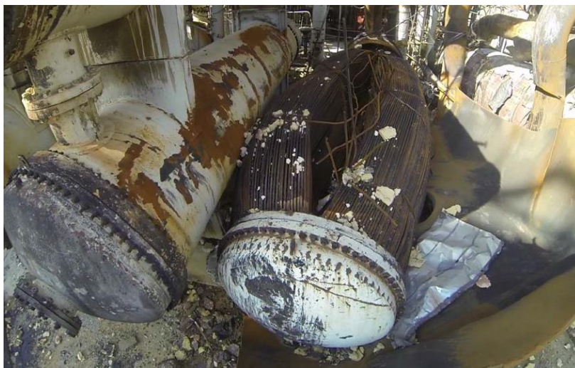
Slika 11. Izmenjivač topline B na kojem je došlo do eksplozije [4]
