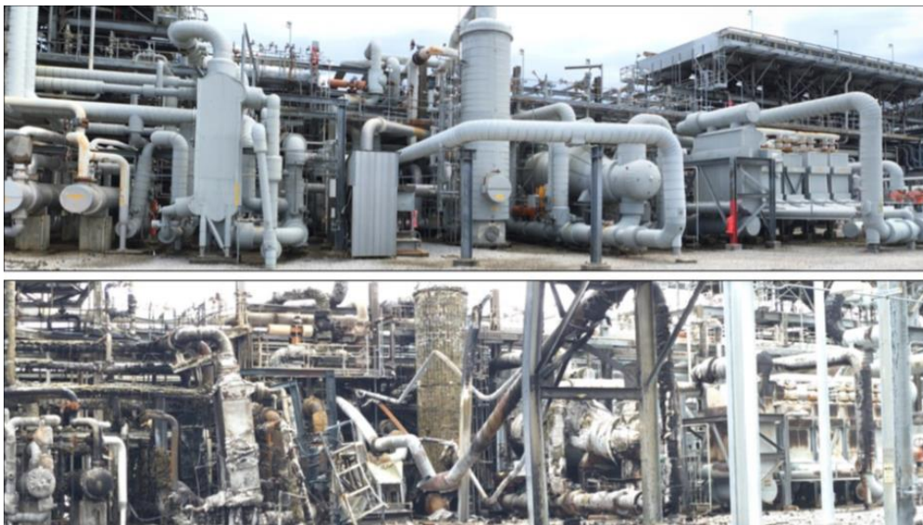
Slika 2. Usporedba požarom stradale kompozicije (dolje) i identične požarom netaknute kompozicije (gore) za preradu sirovog plina [9]
