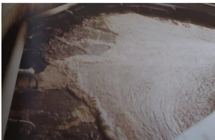
Slika 10. Aerobna stabilizacija mulja na uređaju za pročišćavanje [8]
