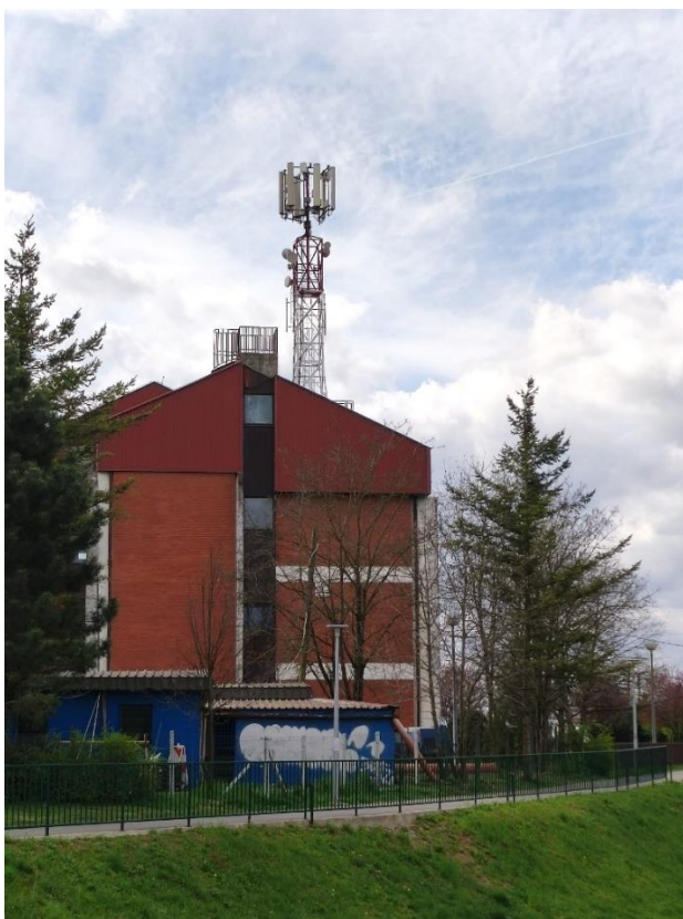
Slika 2. Antenski stup na krovu građevine
