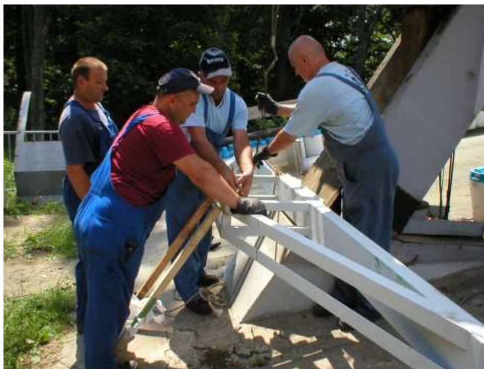
Slika 24 Naprava za preuzimanje nosivog užeta
