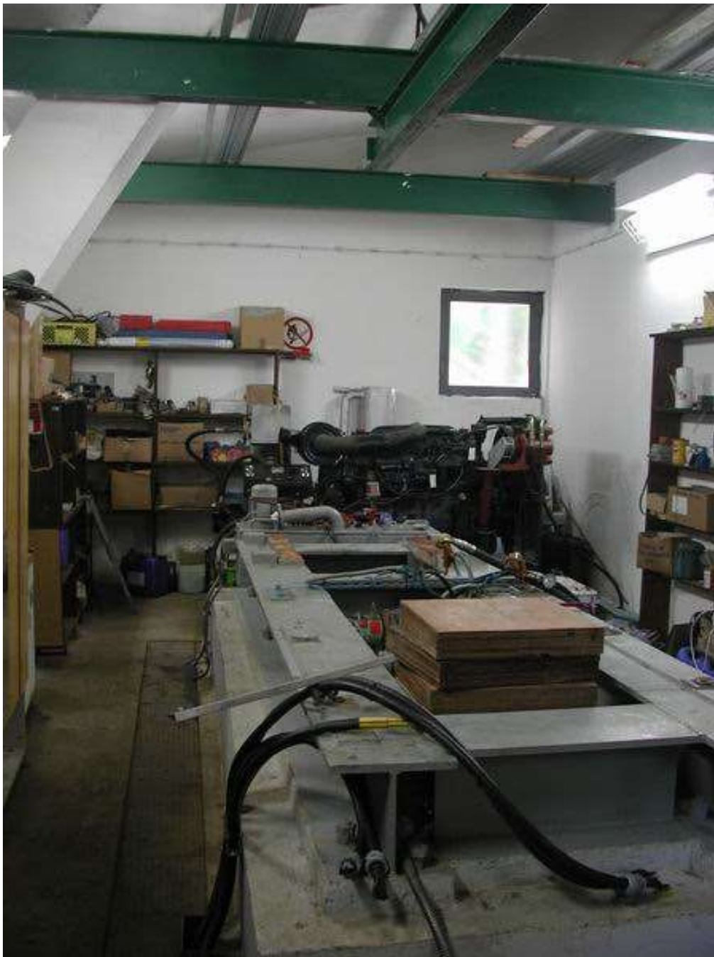
Slika 43 Stanje podzemne strojarnice nakon demontaže
