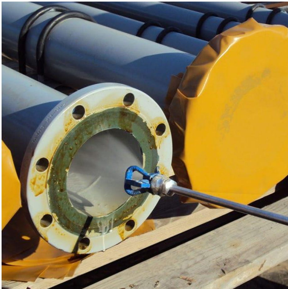
Slika 14. Primjer primjene inhibitora korozije u cjevovodima [29]
