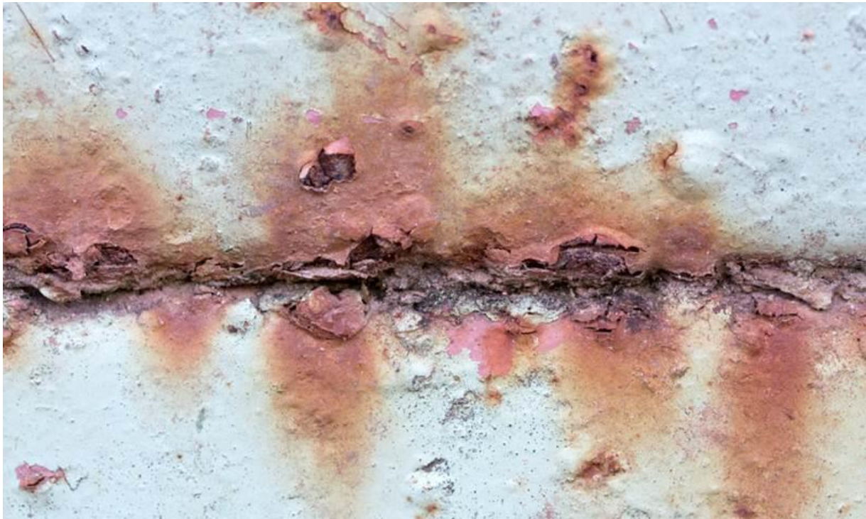
Slika 9. Korozija u procijepu [20]
