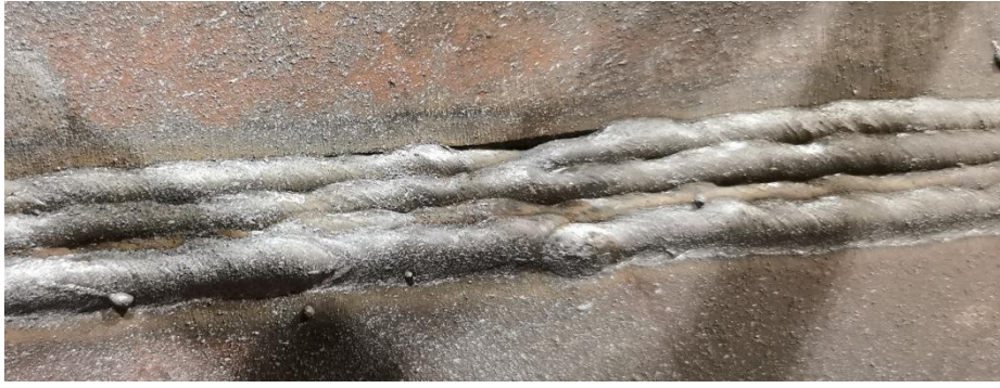
Slika 63. Vizualna greška: nedovoljno ispunjen presjek pripreme zavarenog spoja
