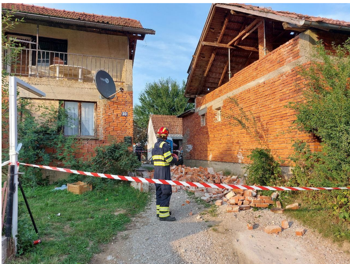
Slika 37. Građevina nakon rušenja zida [17]
