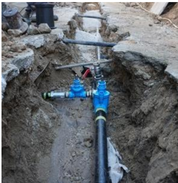
Slika 20. Cjevovod za dopremanje vode[19]
