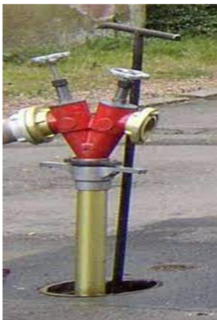
Slika 26. Hdrantski nastavak spojen na podzemni hidrant[19]
