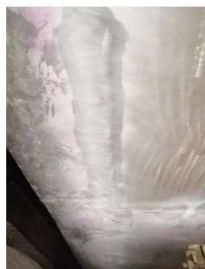
Slika 3. PT zavara između ploča brtvene stijene
