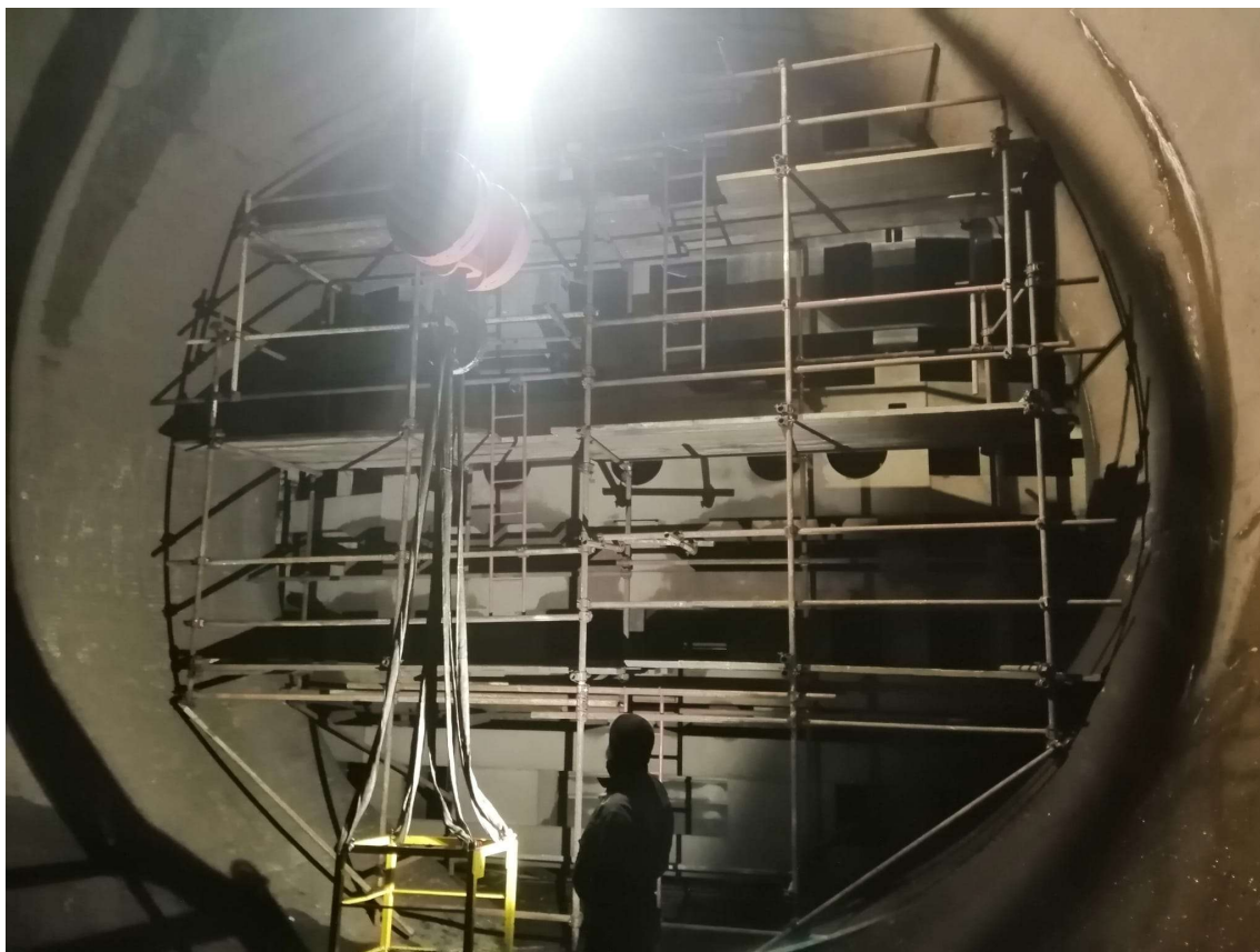
Slika 4.13 Skela u usisnoj cijevi agregata A
