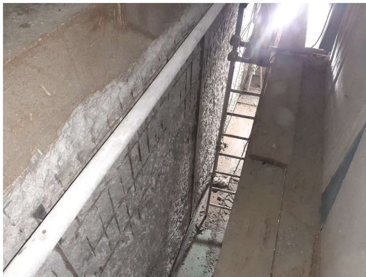
Slika 4.24 Brtveća stijena nakon uklanjanja površinskog sloja betona
