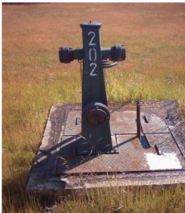
Slika 7: Nadzemni hidrant tipa „Rafinerija nafte Sisak“ [10]
