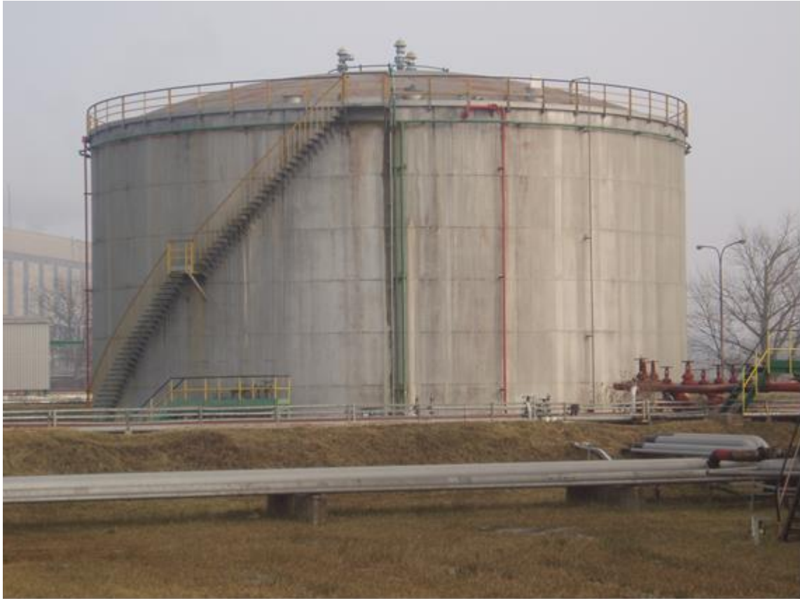
Slika 11: Sustav za hlađenje spremnika raspršenom vodom tipa „Drencher“ [10] 14
