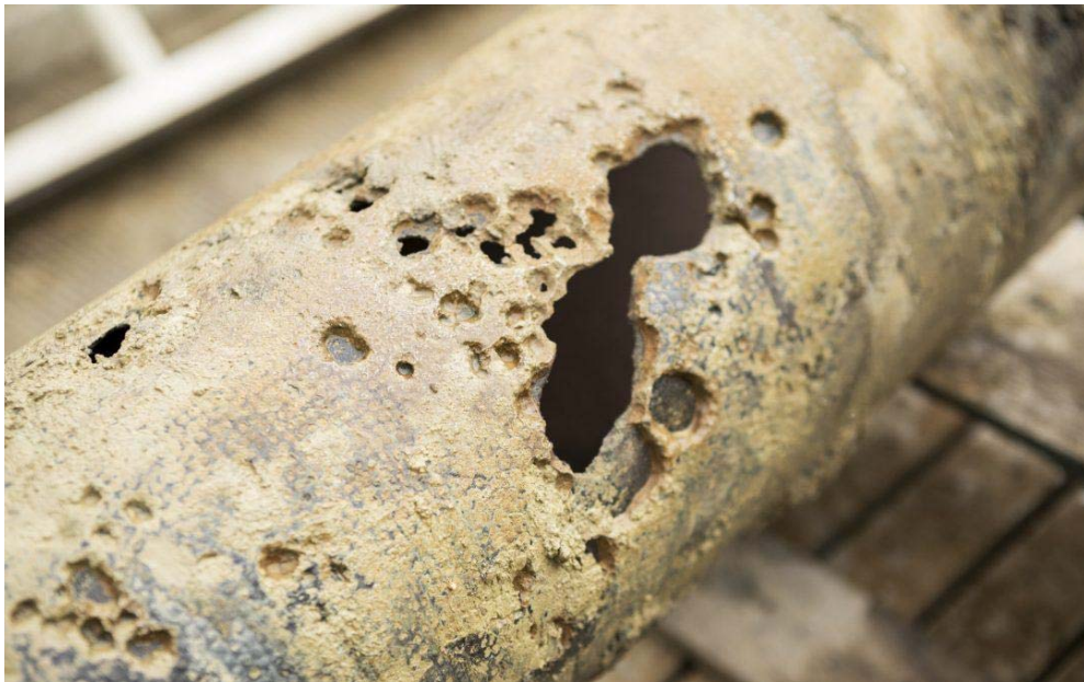
Slika 14. Primjer "pitting" rupičaste korozije [24]
