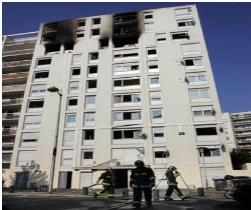
Sl.1. Posljedice požara na višem objektu
