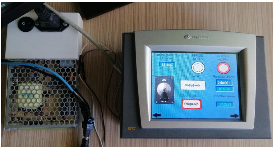
Slika 17: PLC (desno) i napajanje (lijevo)
