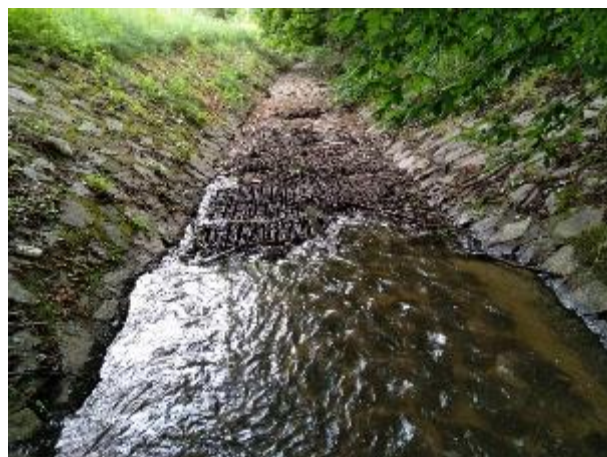
Slika 2. Usisnica akumulacije Novo Zvečevo
