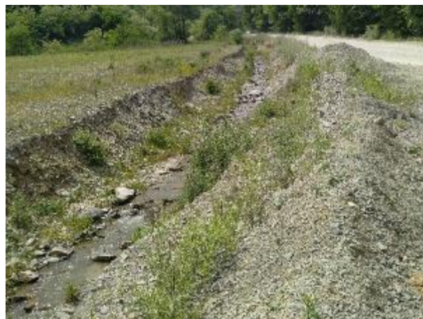
Slika 56. Kanalizirani dio vodotoka
