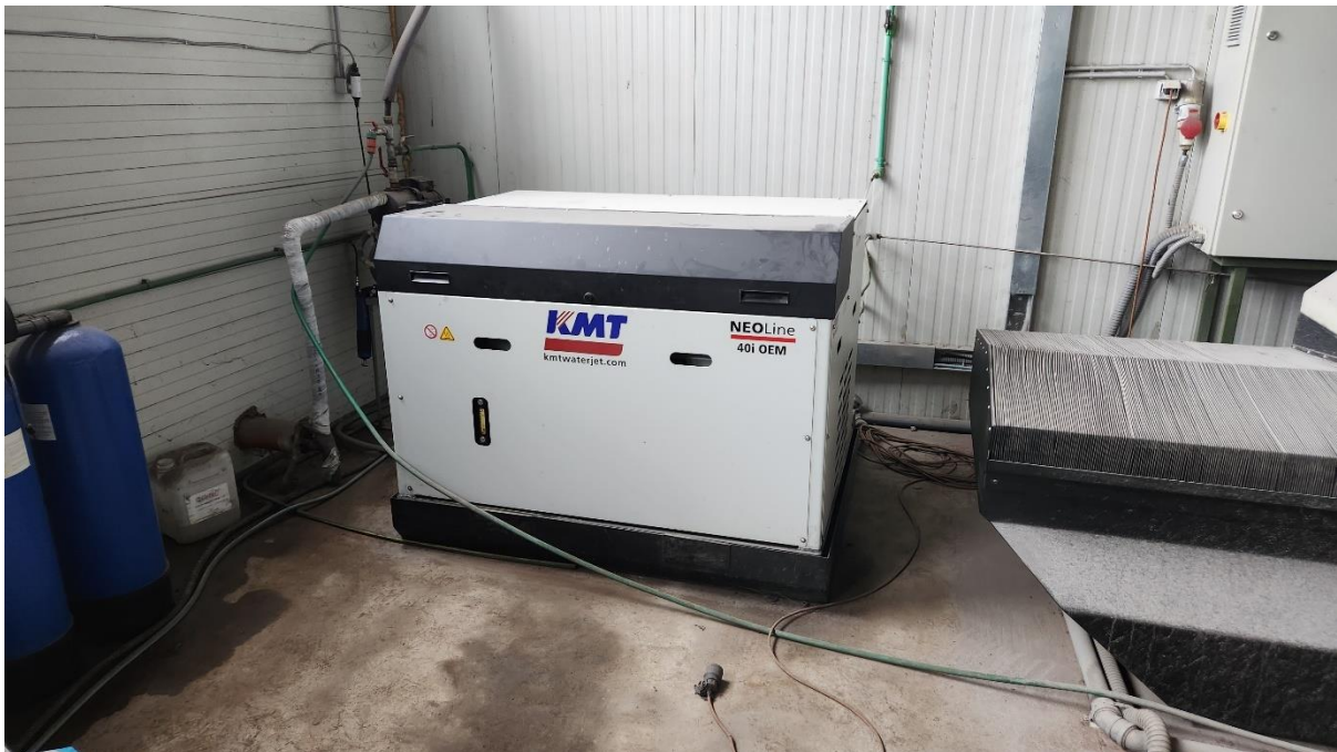
Slika 35. Kućište sustava niskog i visokog tlaka vode
