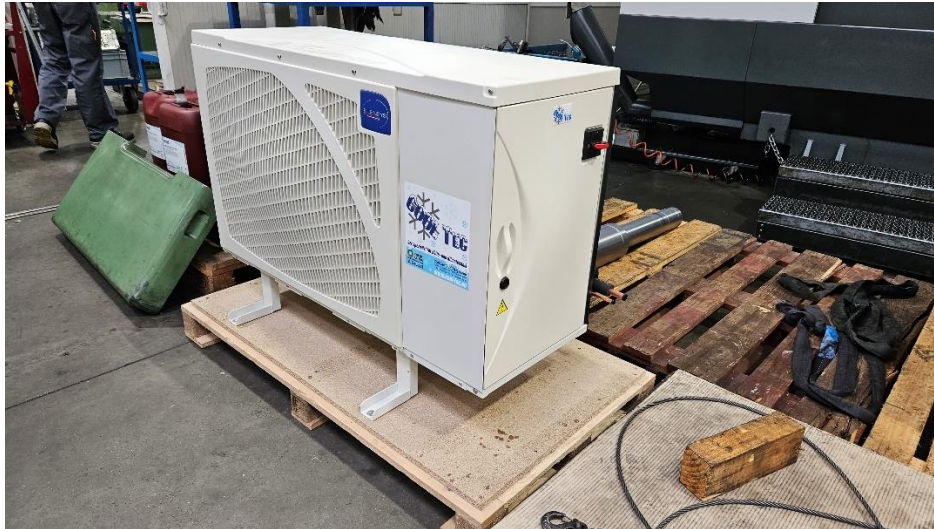
Slika 29. Dodatna unutarnja jedinica za hlađenje ulja[Autor]
