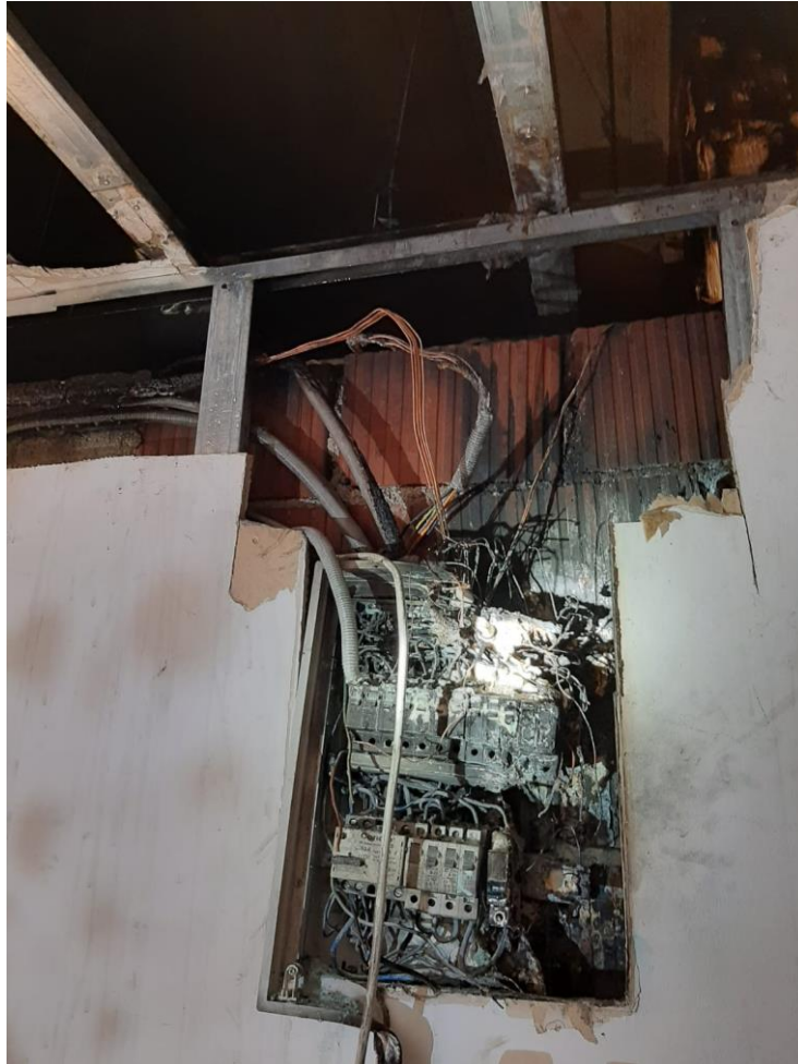
Slika 14. Požar električnih instalacija [12]
