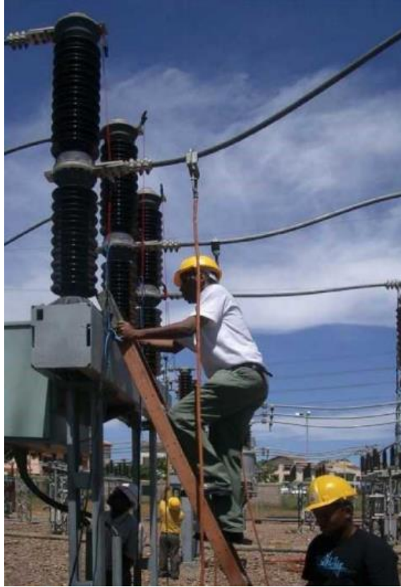
Slika 28. Ispitivanje prekidača uzemljenja [21]
