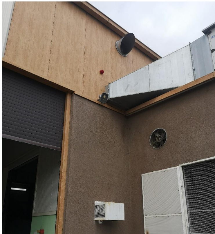
Slika 34. Adresabilna alarmna sirena na ulazu u postrojenje [5]
