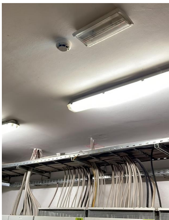
Slika 38. Protupanično osvjetljenje elektroprostorije [5]
