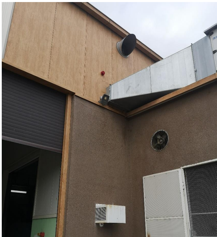
Slika 34. Adresabilna alarmna sirena na ulazu u postrojenje [5]
