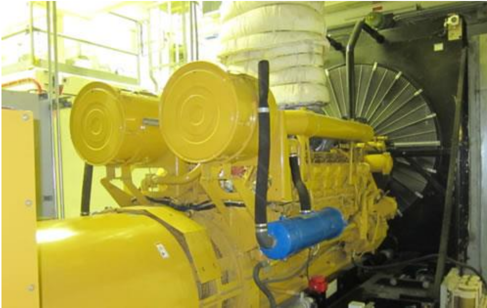
Slika 6. Generatori struje za hitne slučajeve [9].
