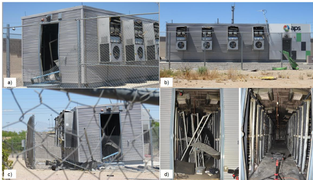
Slika 18. Prikaz postrojenja McMicken BESS-a nakon eksplozije, pod a) oštećenje stražnjih vrata i HVAC sustava, b) izbačena bočna vrata, c) krhotine i oštećenja stražnjih vrata i d) unutarnje oštećenje sustava [28]
